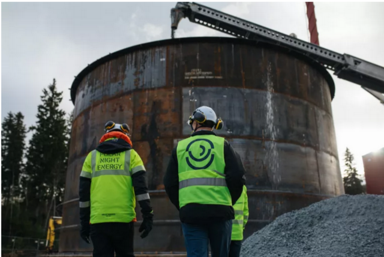
Polar Night Energy's CEO Tommi Eronen, Tulikivi's CEO Heikki Vauhkonen and Loviisan Lämpö's CEO Mikko Paajanen met at the construction site of the new Pornainen Sand Battery.
